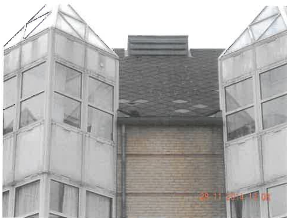
Nedfaldet eternitskifferplade gårdfacade 134B- 134C
