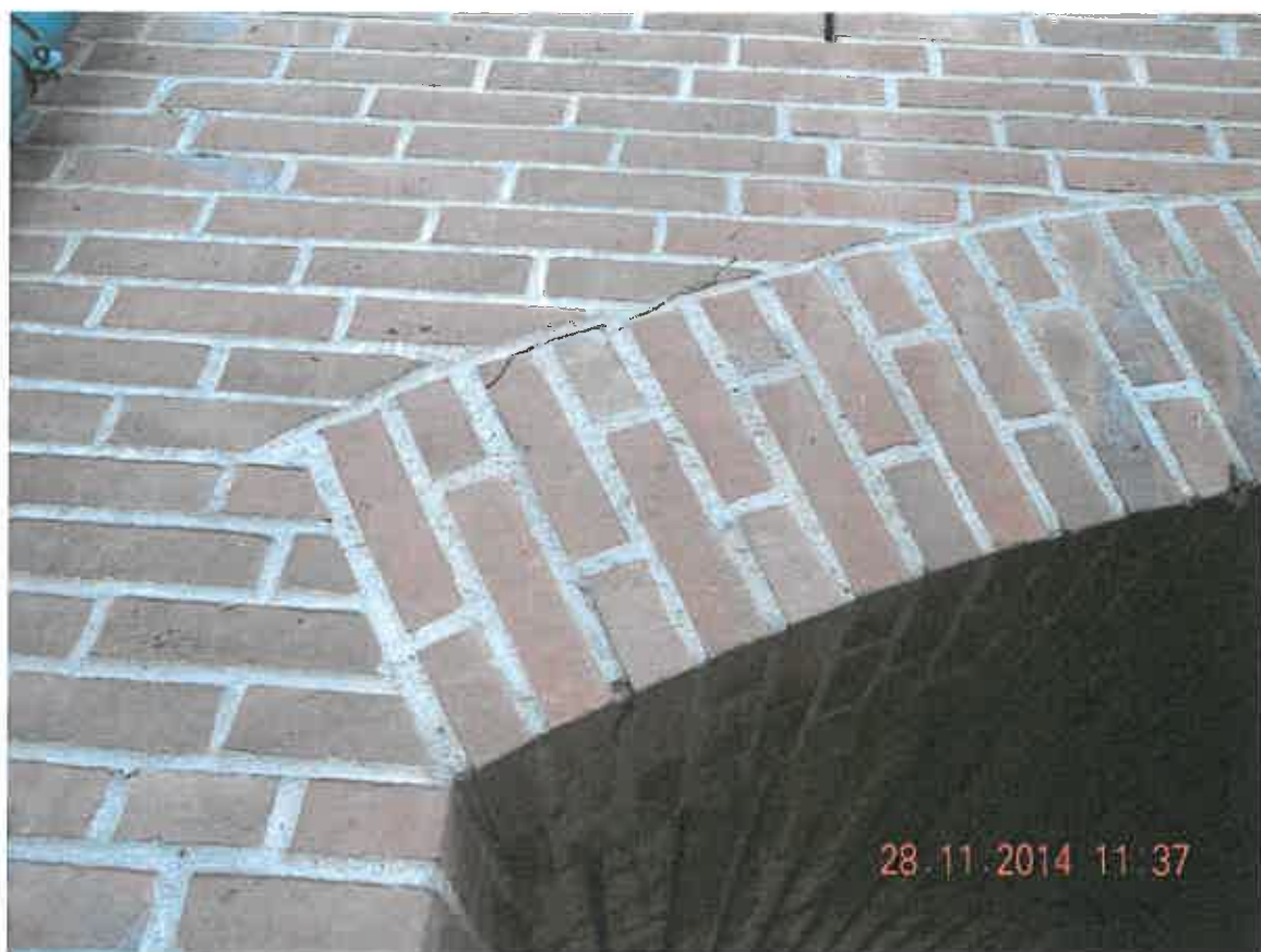
Sætningskade ved port nr. 128
