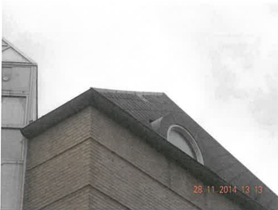
Manglende eternitskifferplade ved grat 126 D
